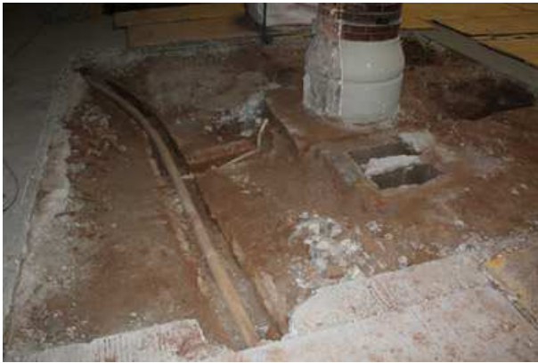
Vista general del pilar 8 amb totes les estructures localitzades. A l'esquerra apareix la conducció de gas amb el seu tub de plom. En el centre la trapa de la canalització d'aigües i al fons el cub de formigó.
